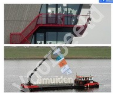
De draagpunten van het bouwhekwerk zijn nu klaar en worden nu met een kraan opgehoofd.
